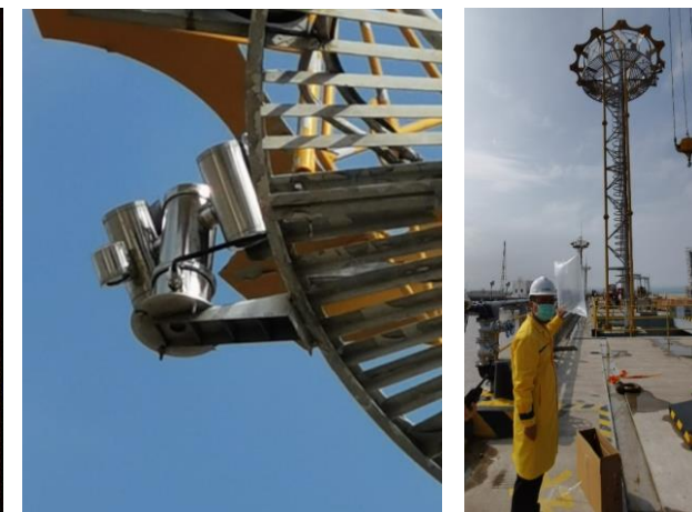
浙江省LNG受入基地
