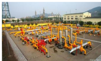
LNGステーション
