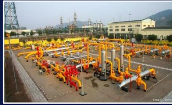
LNGステーション
