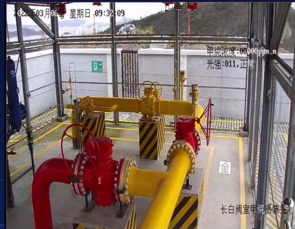
浙江省のLNGバルブルーム
