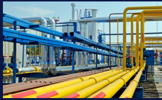
LNGパイプライン
