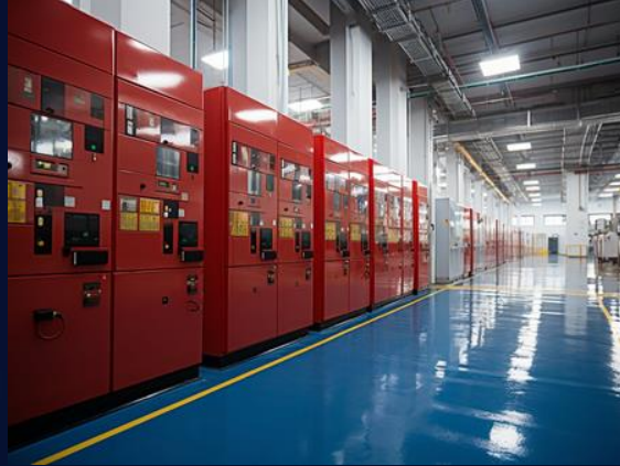
設備のモニタリング
